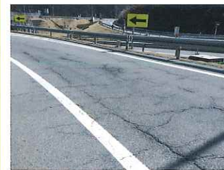
舗装損傷状況 現状
